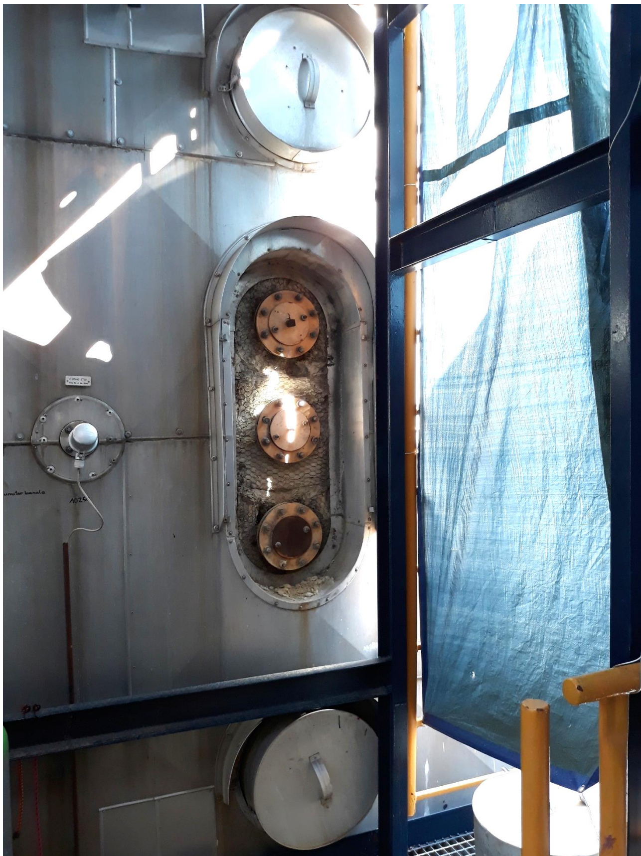
Sl. P 6: Dodatni mjerni priključci mjernog mjesta nakon REA
